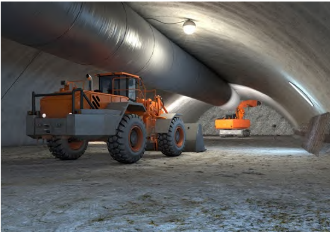
Abb. 141 Belüftung im Kalottenvortrieb
