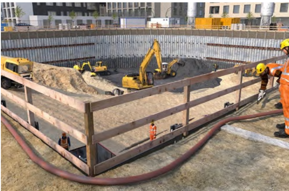
Abb. 4 Dreiteiliger Seitenschutz als Absturzsicherung an Baugruben
