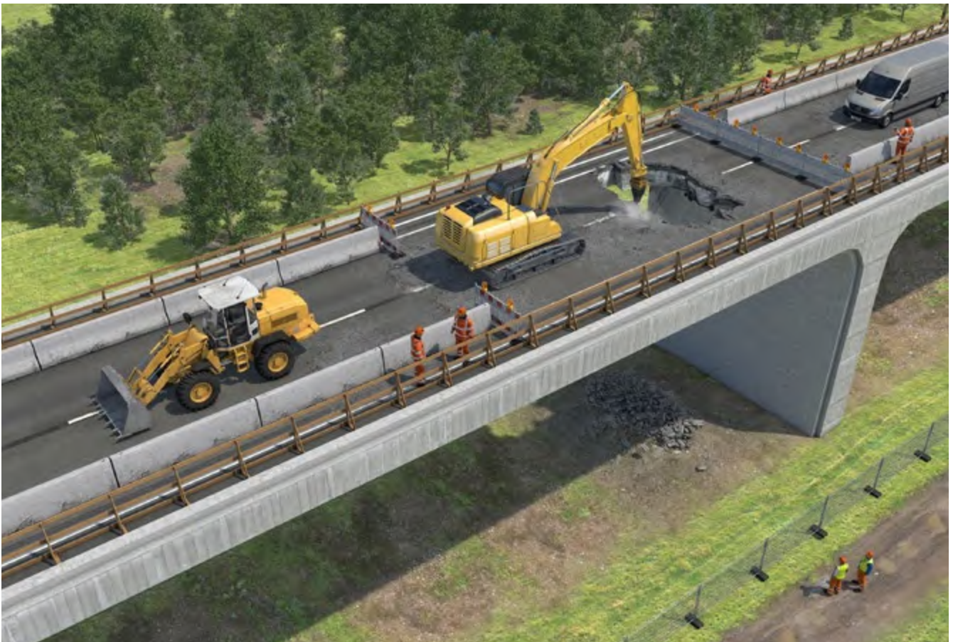
Abb. 76 Absturzsicherung für Fahrzeuge und Baumaschinen durch massive Begrenzung des Fahrweges
