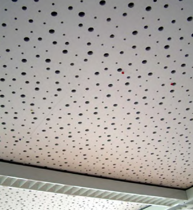
Abb. 13 In der Regel reicht schon eine schallabsorbierende Deckenfläche mit einem guten schallabsorbierenden Material um die raumakustischen Verhältnisse zu verbessern.
