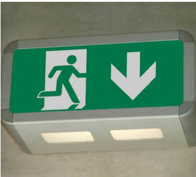
Abb. 9 Fluchtwege sind deutlich erkennbar und dauerhaft zu kennzeichnen.
