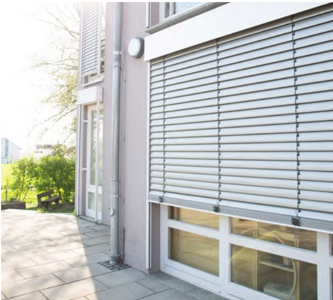
Abb. 10 Außenliegende Jalousien können ein Aufheizen der Räume verhindern.
