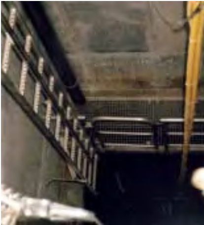
Bild 8: Steigleiter mit Seitenholmen, Steigschutzeinrichtung und Podest
