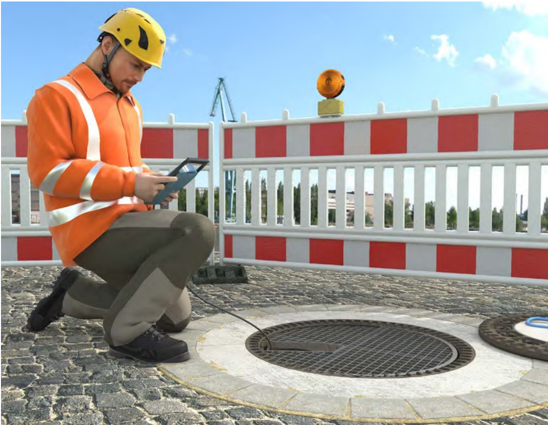
Abb. 29 Eine durch Unterweisung oder Schulung fachkundige Person übernimmt das Freimessen. Mit Hilfe von Ansaugschläuchen kann die Atmosphäre weiter unten geprüft werden.
