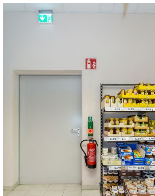
Abb. 26 Feuerlöscher gut erreichbar in Greifhöhe
