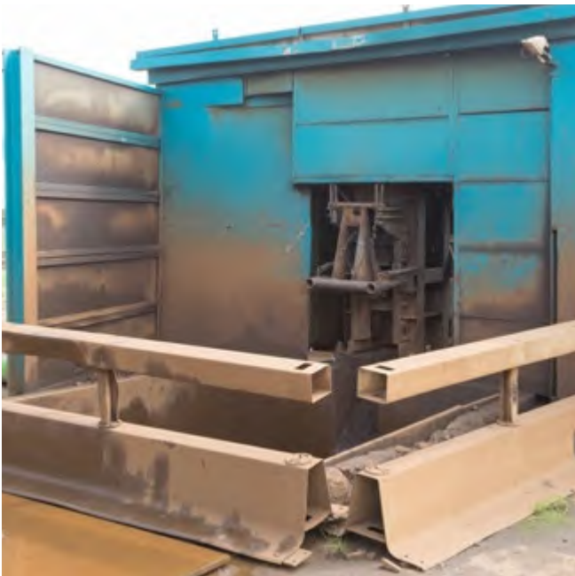
Abb. 51 Absturzsicherung an Grube eines Schienenbrechers
