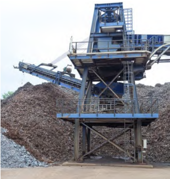
Abb. 70 Mehrdimensional einstellbare Austragbänder zur Reduzierung von Staub und Lärm
