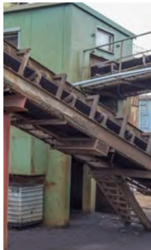
Abb. 42 Mit abnehmbaren Verkleidungen gesicherte Untergurtrollen
