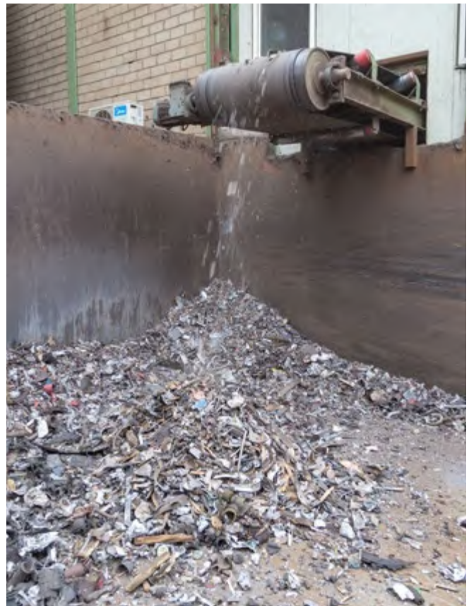
Abb. 44 Trennwände im Abwurfbereich
