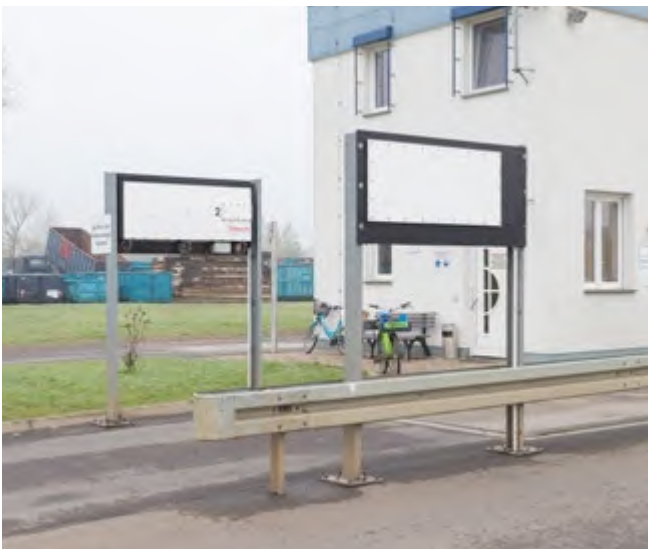
Abb. 20 Stationäre Messanlage für LKW an der Zufahrt
