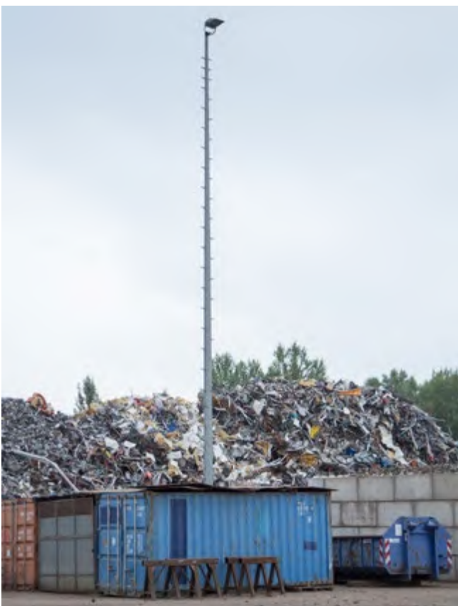
Abb. 98 Beispiel für Anlage, die einen großen Bereich ausleuchtet
