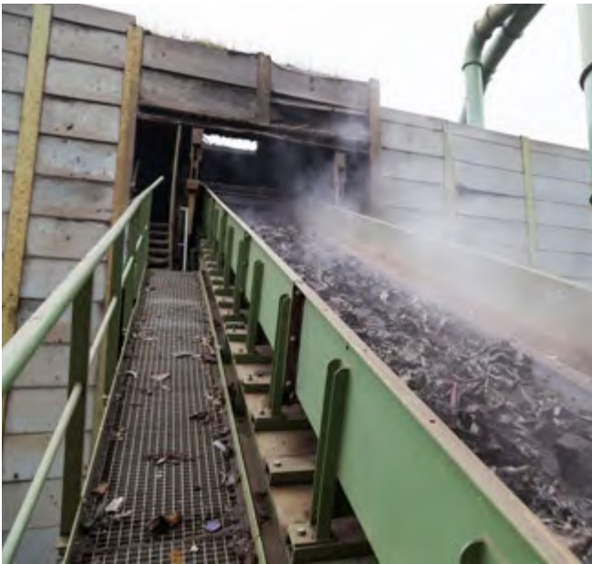
Abb. 43 Ausreichend breiter und mit Geländer versehener Laufsteg neben einem Gurtförderer
