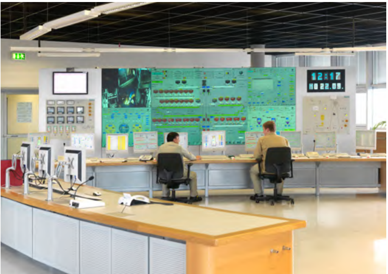
Bild 3 Moderner Leitstand einer komplexen Anlage der Hüttenindustrie
