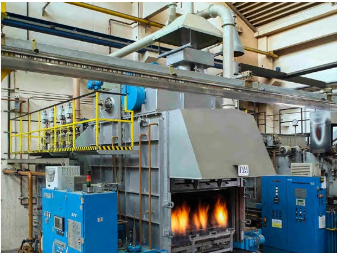
Abb. 17 Absaugungen an einem Mehrzweckkammerofen
