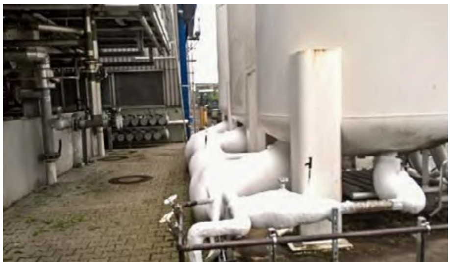
Abb. 31 Eisbildung an Rohrleitungen von Stickstofftanks
