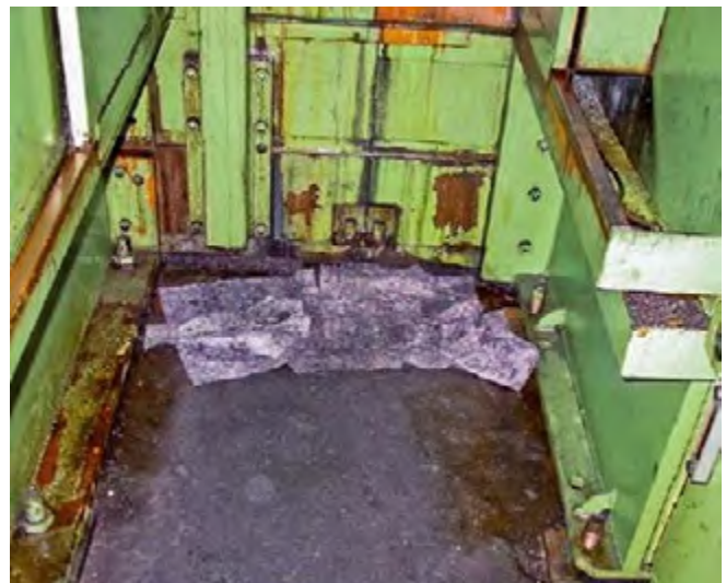
Abb. 4 Erhöhte Brandlast durch ölgetränkte Putztücher
