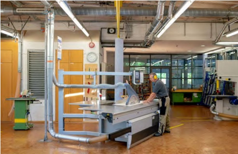
Abb. 2.2.3-01 Absauganlage an einer Holzbearbeitungsmaschine
