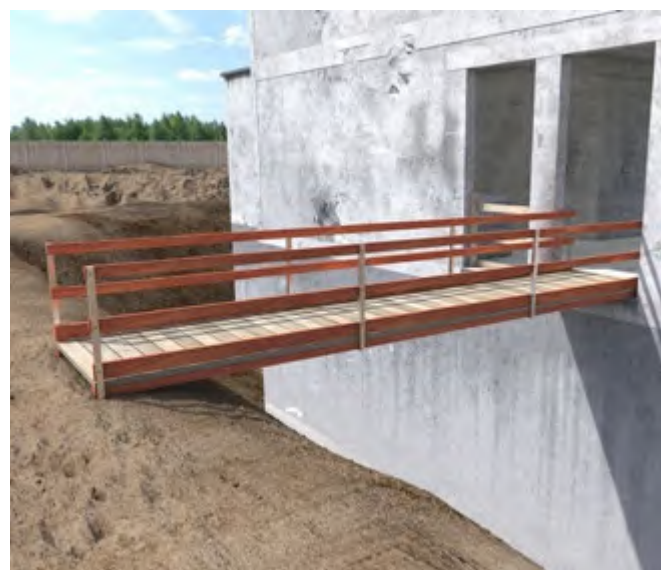
Abb. 3.5.2-03 Laufsteg mit Seitenschutz als Verkehrsweg
