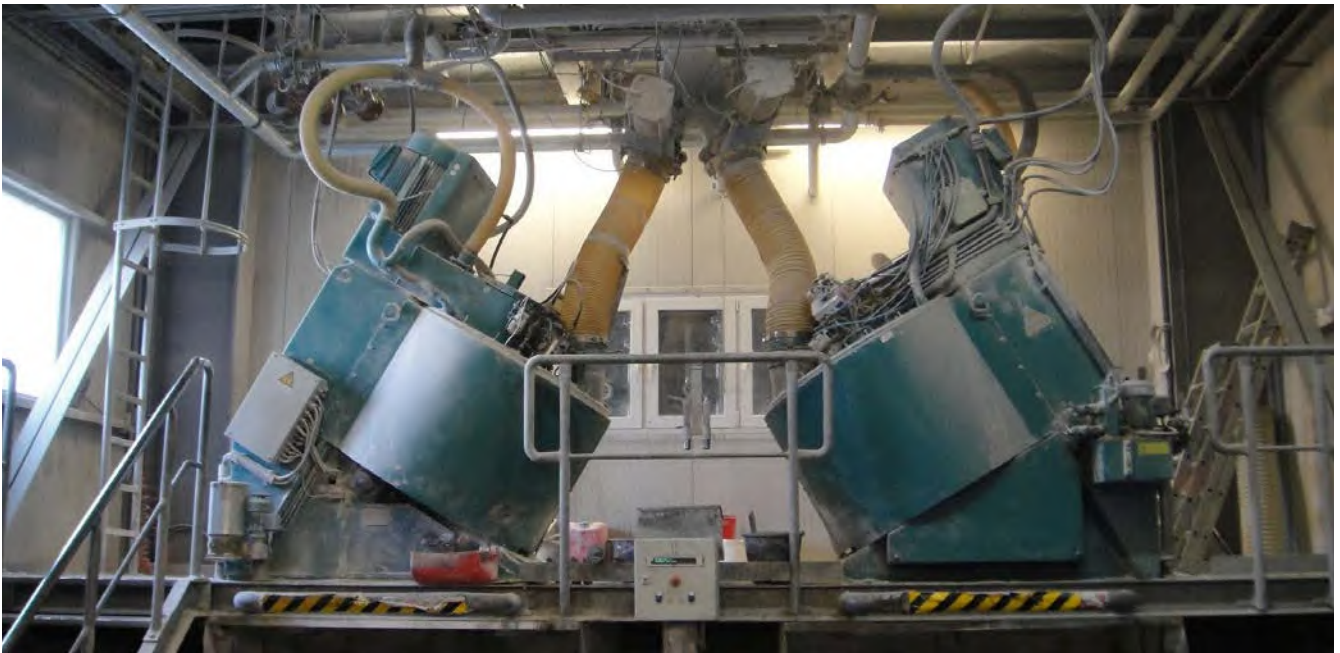
Abb. 89 Mischanlage mit Abluftabsaugung
