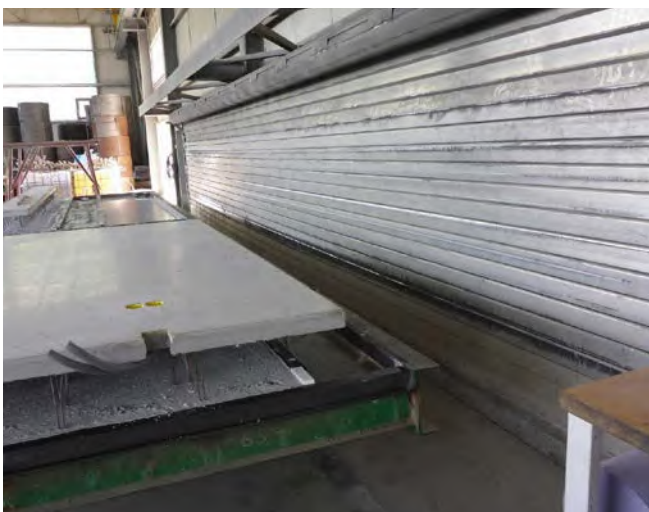
Abb.10 Sicherung Paletteneinfahrt durch Rolltor
