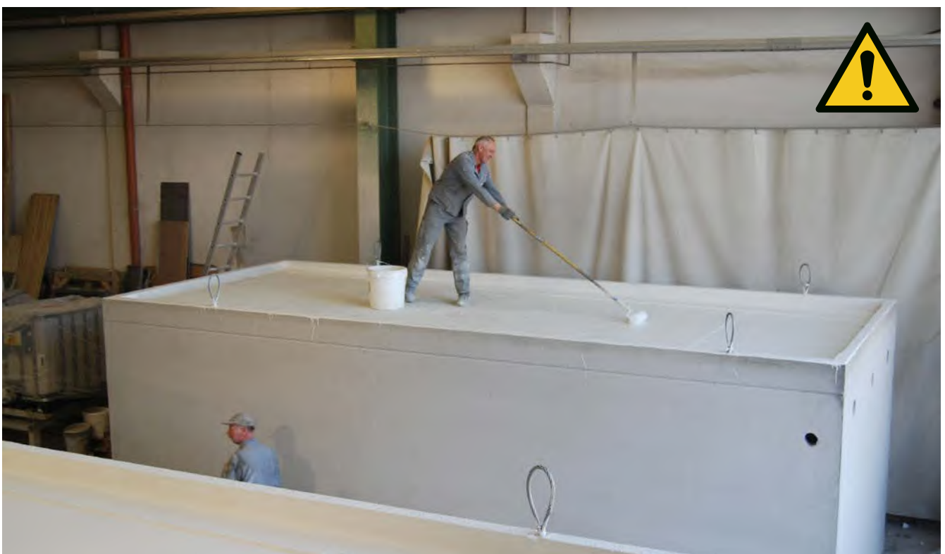
Abb. 87 NEGATIV: Arbeiten ohne Absturzsicherung
