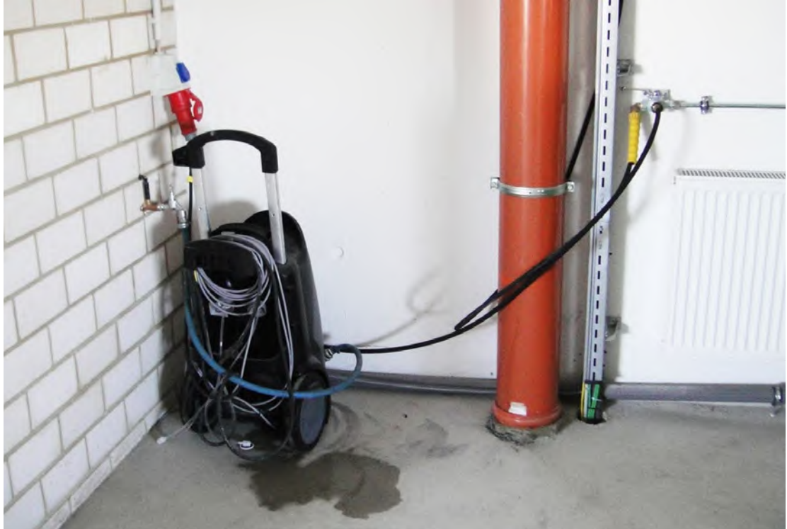
Abb. 26 Zentral untergebrachter Hochdruckreiniger für Reinigungsarbeiten mit Verteilleitung
