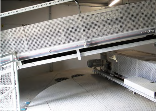
Abb. 20 Gurtbandförderer mit erforderlichen Schutz- und Sicherheitseinrichtungen
