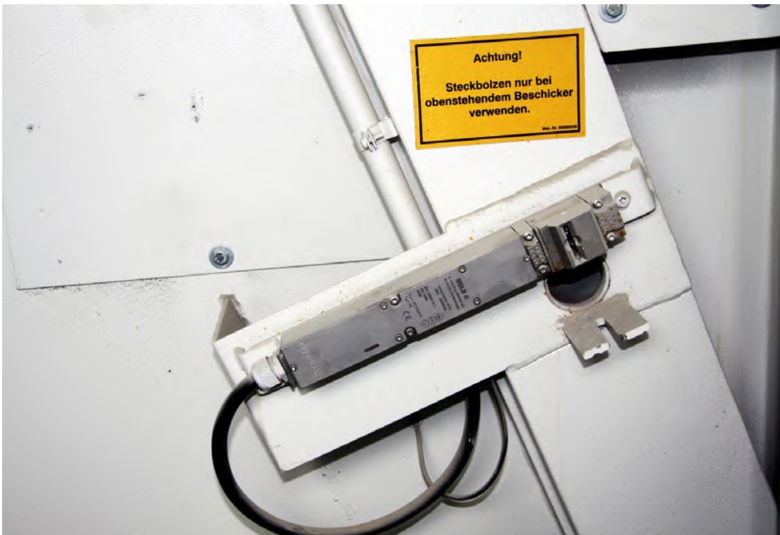
Abb. 25 Stellungsüberwachung für den Steckbolzen der Kübelaufzugsbahn
