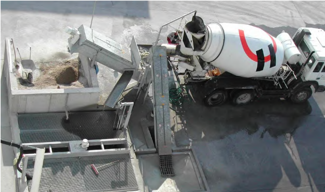
Abb. 36 Recyclinganlagen mit abgedeckten Absetzbecken
