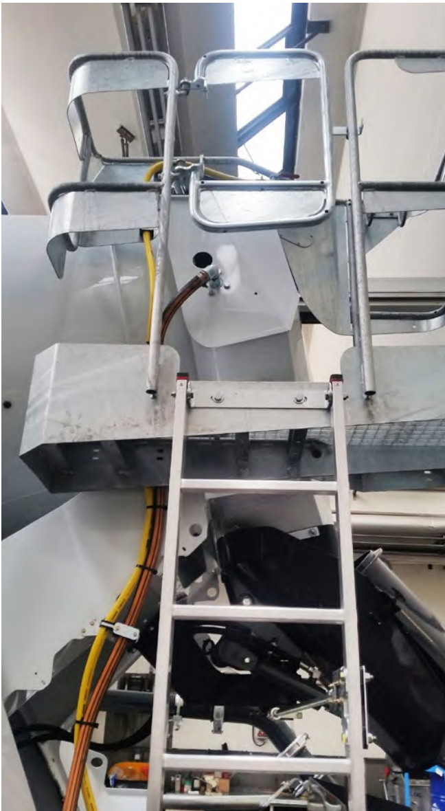
Abb. 44 klappbare Absturzsicherung am Aufstieg
