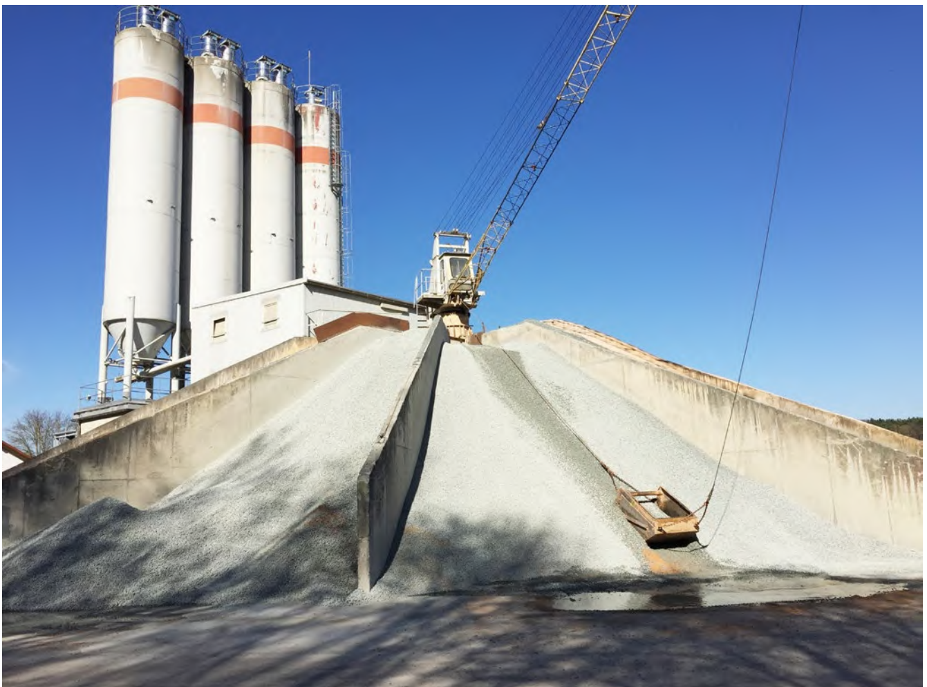
Abb. 1 Frischbeton Sternanlage mit Kabine
