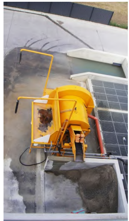
Abb. 28 Recyclinganlage mit abgedecktem Becken
