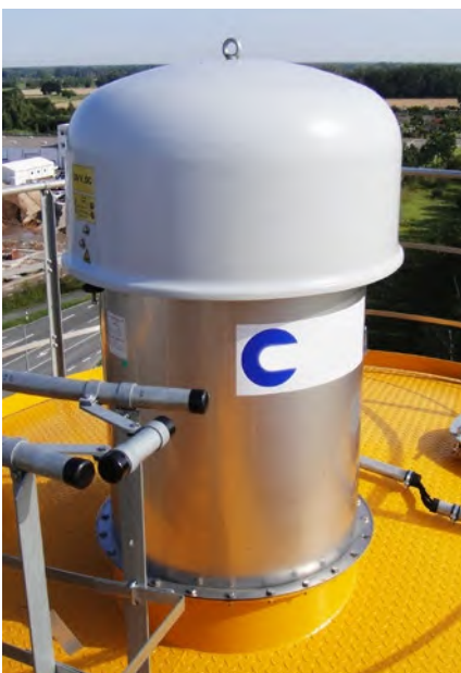
Abb. 40 Filteranlage auf einem Silo
