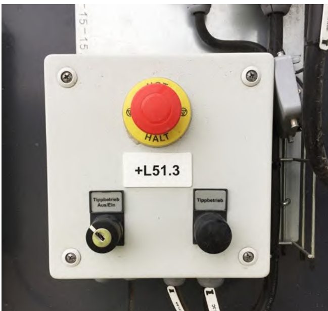
Abb. 18 Vor-Ort-Steuerung um Becher des Becherwerkes zu positionieren
