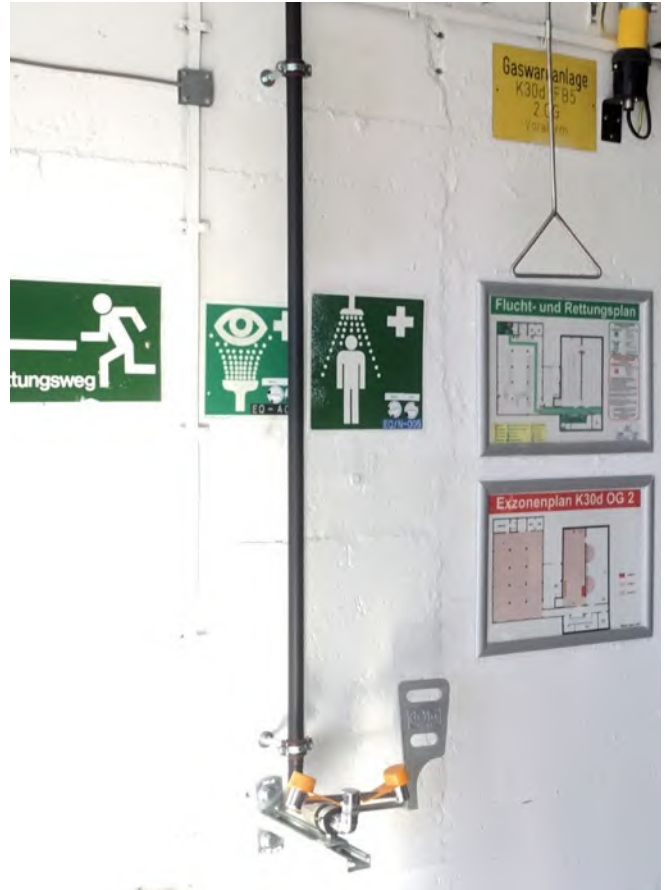
Abb. 5 Körper- und Augennotdusche
