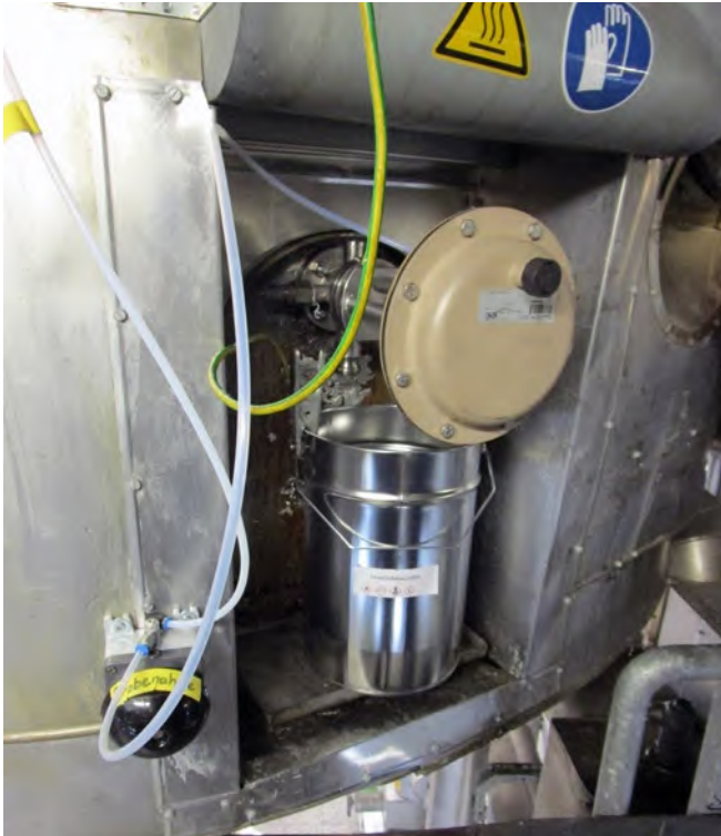
Abb. 25 Pneumatisches Probenahmeventil am Mischer
