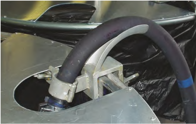
Abb. 3 Befestigung einer Schlauchleitung am Kesselrand
