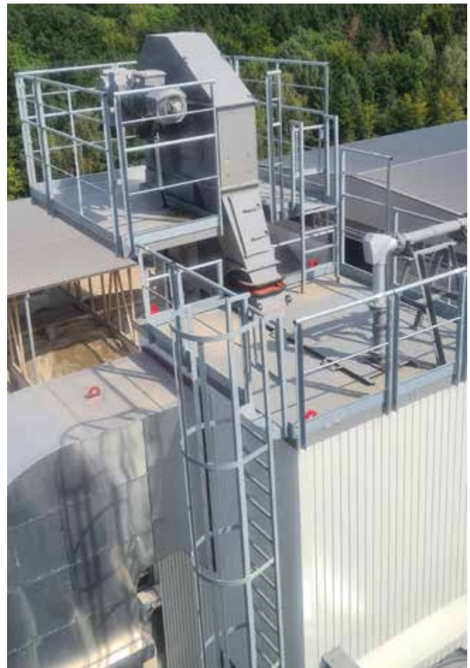
Abb. 65 Umlaufende Arbeitsbühne am Becherwerkskopf
