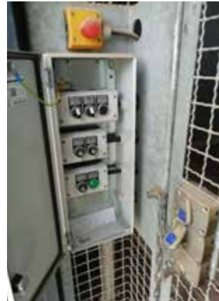
Abb. 53 Schlüsseltransfersystem und Vor-Ort-Steuerung
