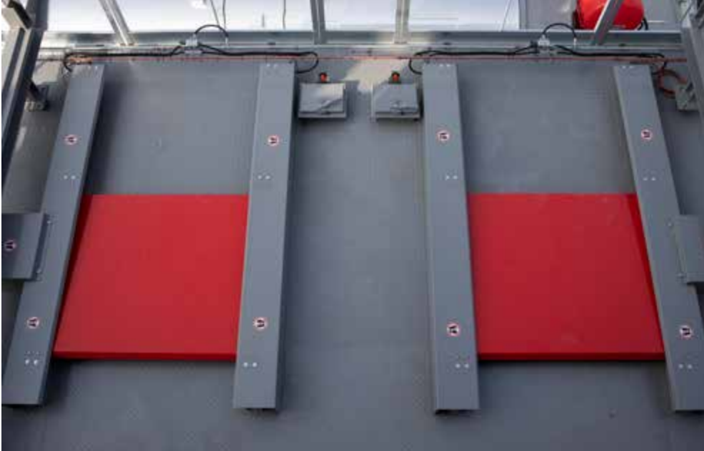
Abb. 68 Verfahrkübelebene mit Lukendeckeln
