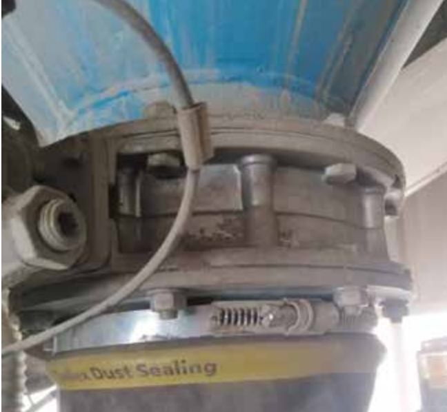
Abb. 73 Dichtung zwischen Füllersilo und Abzugseinrichtung
