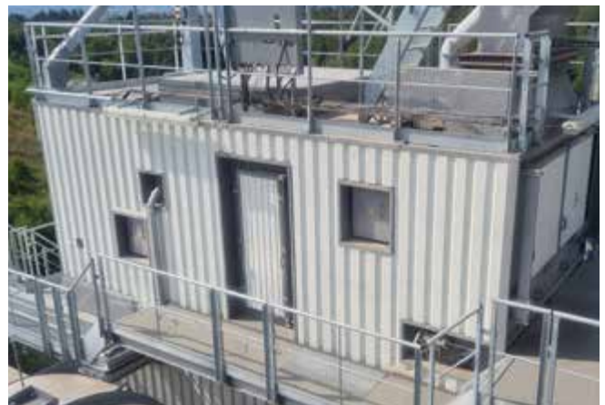
Abb. 42 Sichere Verkehrswege am/auf dem Siebdach
