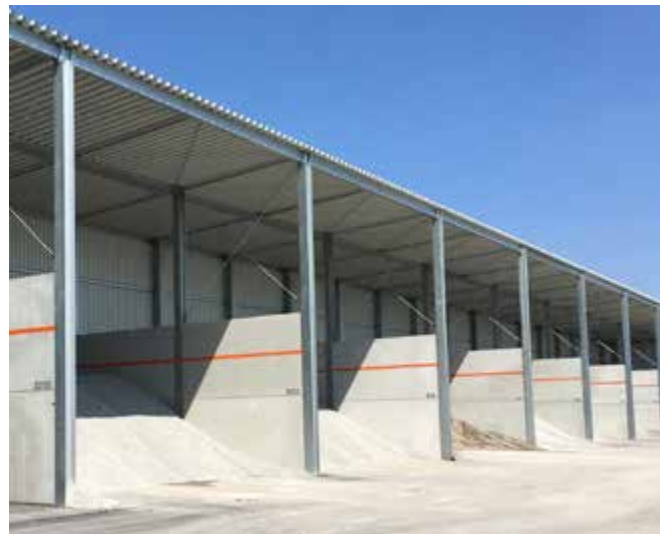
Abb. 41 Die Überdachung der Mineralhalde ermöglicht die trockene Lagerung der Mineralstoffe und mindert diffuse Staubemissionen. Der Eintritt von brennbaren Fremdkörpern wird reduziert.
