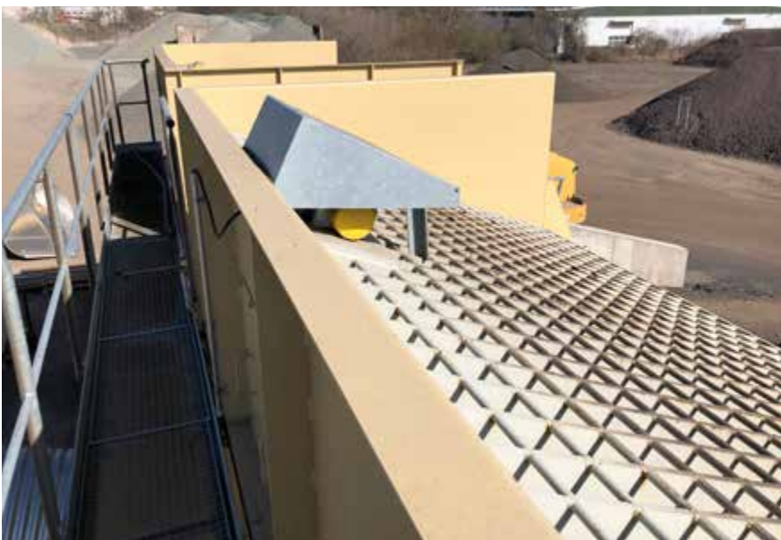
Abb. 28 Doseur mit Rostabdeckung, Laufsteg und Rüttler
