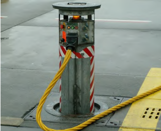
Abb. 32 Ortsfeste Stromversorgung für Luftfahrzeuge
