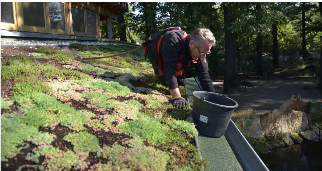
Abb. 55 Grünpflegearbeiten mit Absturzgefahr
