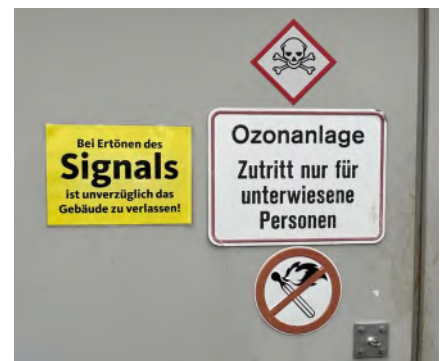
Abb. 44 Zugang zu einer Ozonanlage
