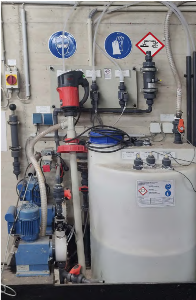
Abb. 40 Gefahrstoffe in der Wasseraufbereitung
