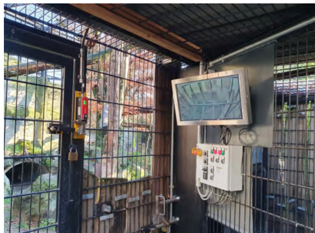
Abb. 15 Verriegelung einer Gehegetür durch eine Sicherheits-SPS
