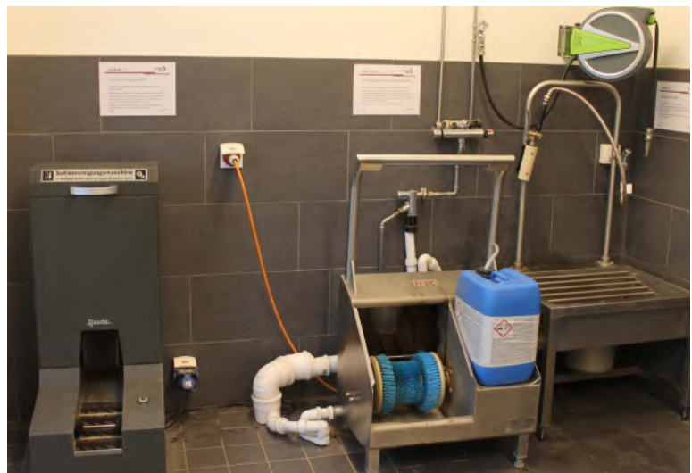
Abb. 65 Schuhreinigungs- und Desinfektionsanlage
