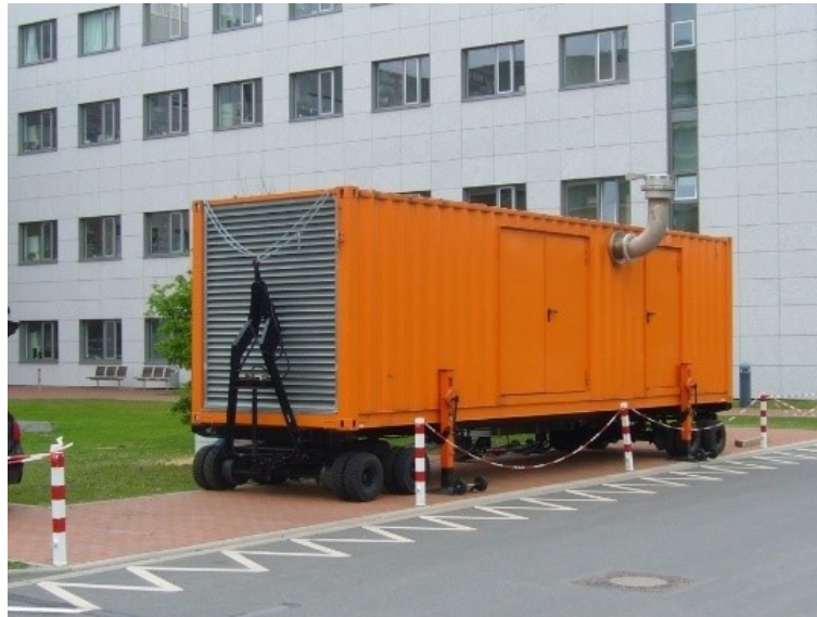
Abbildung 9: Mobile NEA auf einer geeignet vorbereiteten Aufstellfläche
