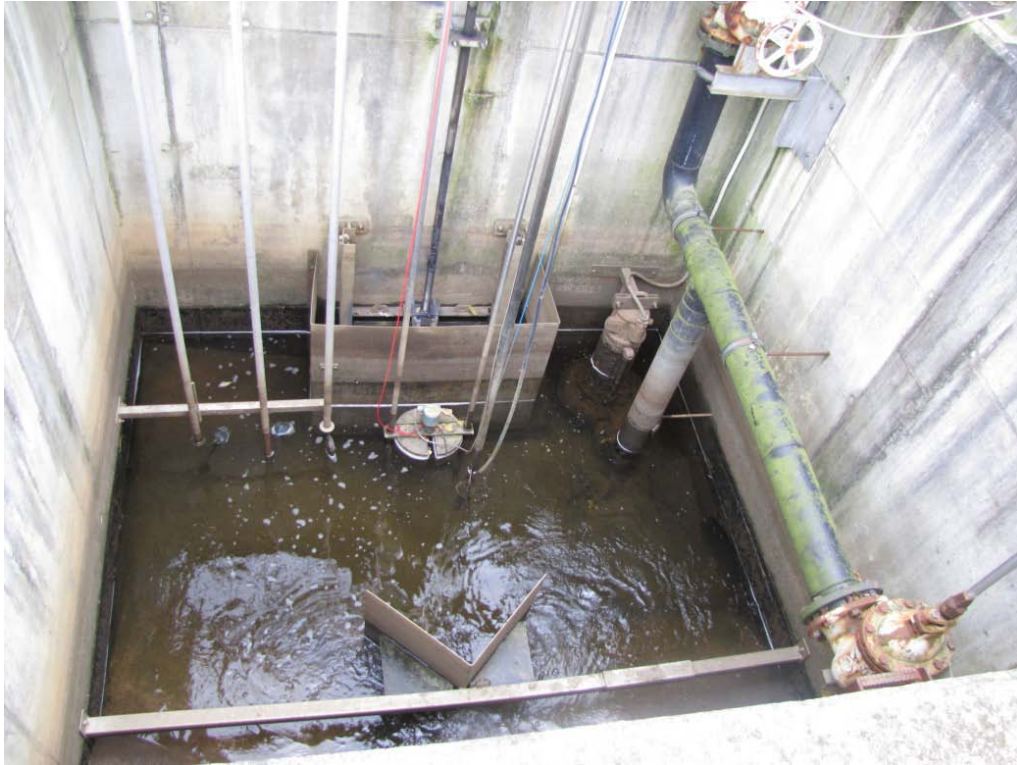
Anhang 6, Abb. 5: Sammelschacht vor der Einleitungsstelle K2 mit fernbedienbarer Verschlusseinrichtung und Messsonden für pH-Wert und Temperatur
