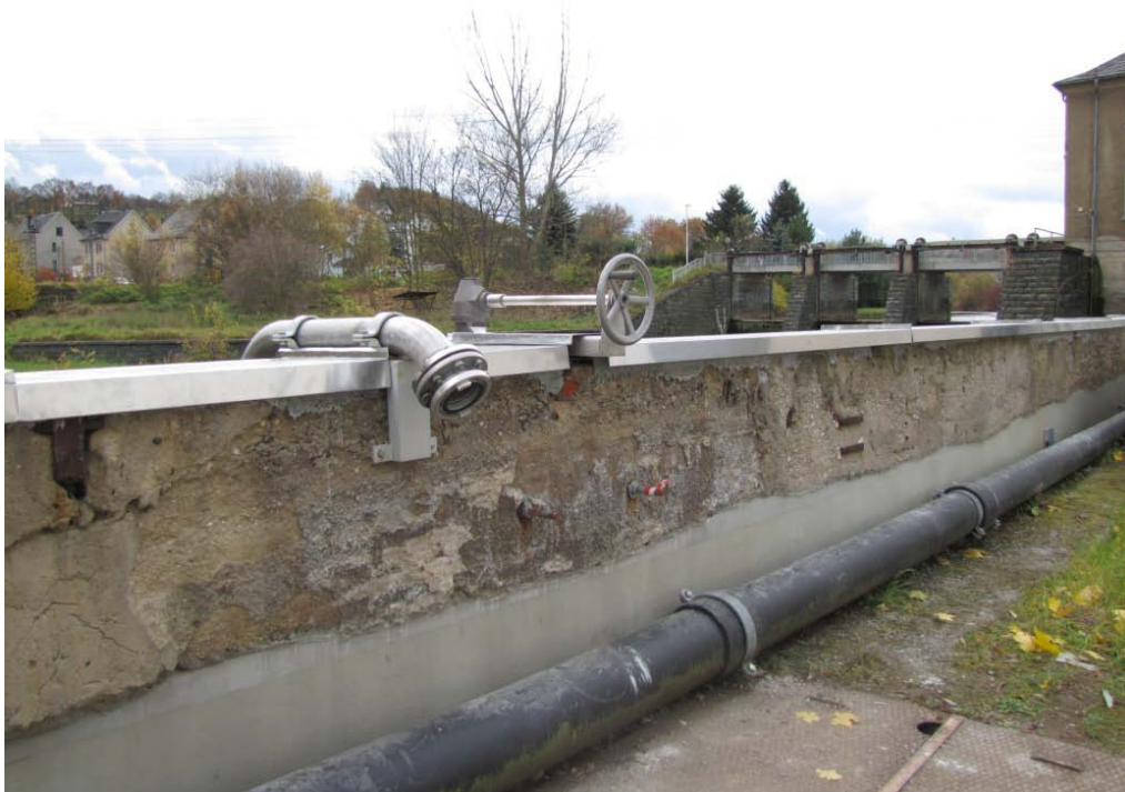
Anhang 6, Abb. 6: Ufermauer mit Anschlussleitung zum Überpumpen durch die Werksfeuerwehr und Handrad zum Bedienen des Verschlusses von K1 (im Hintergrund rechts das Wehr mit Kraftwerk)
